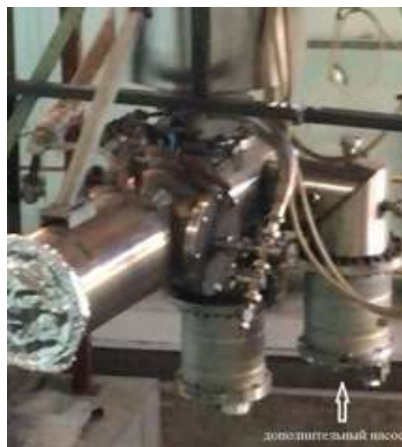
Рисунок 2. Установленный дополнительный насос.
