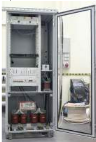
Рисунок 5. Шкаф низковольтного питания ламп ТН-781.
