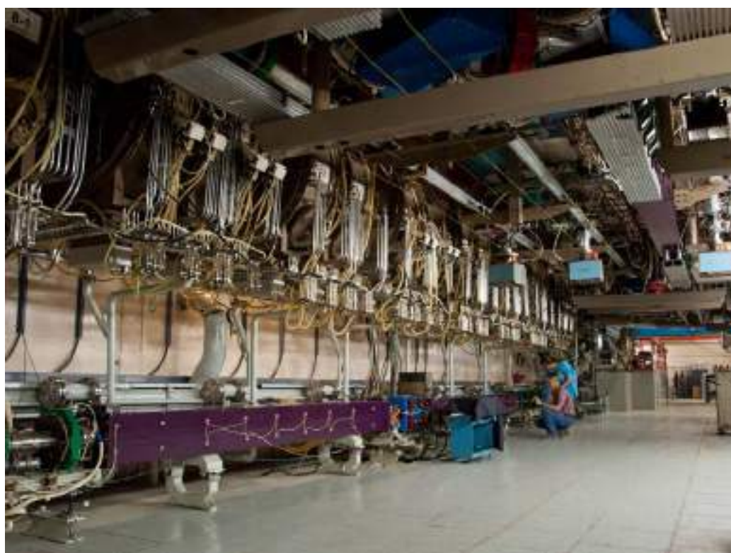
Рисунок 4. Новосибирский ЛСЭ в ускорительном зале.
